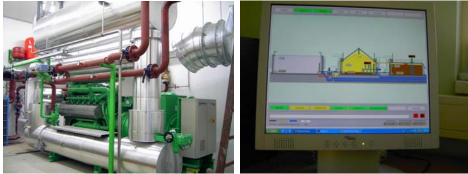
Şekil-3: Hayvansal Atık Arıtım Biyogaz Tesisi Elektrik Üretim Gaz Motoru ve Tesisin Kontrol Ünitesi (Güssing-Avusturya) (Tolay vd., 2008; www.aev-biogas.de).
